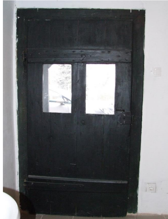
22. kép: Pallótokos ajtó belső oldal (2021. január)
